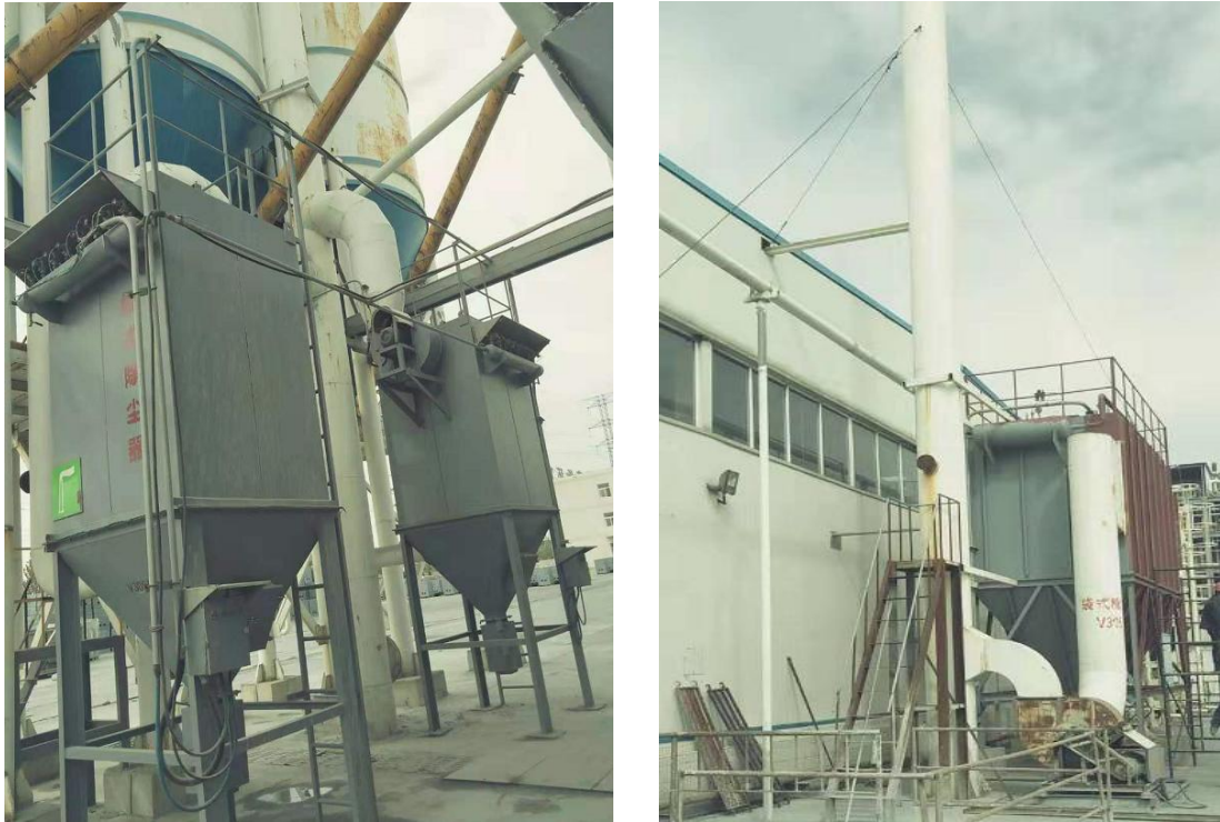
图 3-2 布袋除尘器及排气筒
